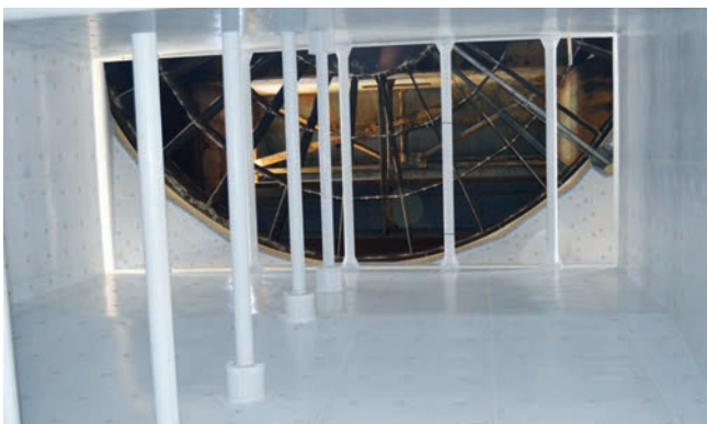
PFA Auskleidung in einem Rohgaskanal
