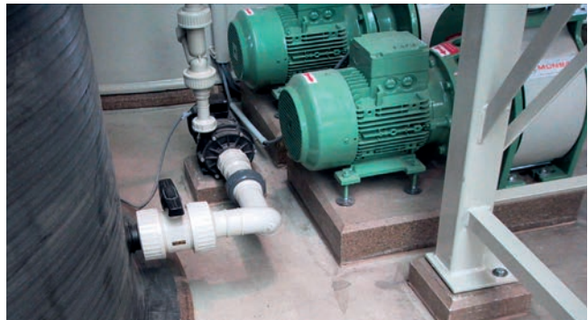
Polybetonsteine als Pumpen- und Apparatefundament
