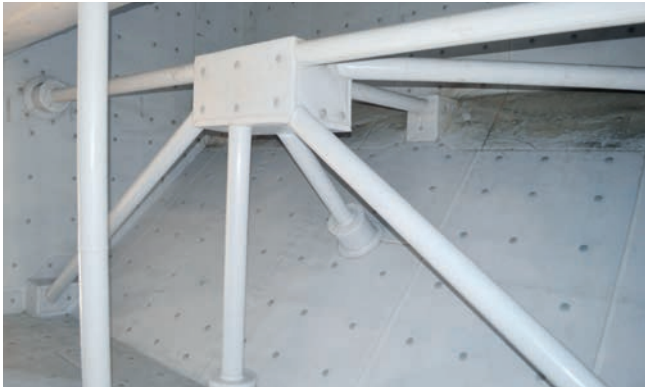
PFA Auskleidung in einem Rohgaskanal
